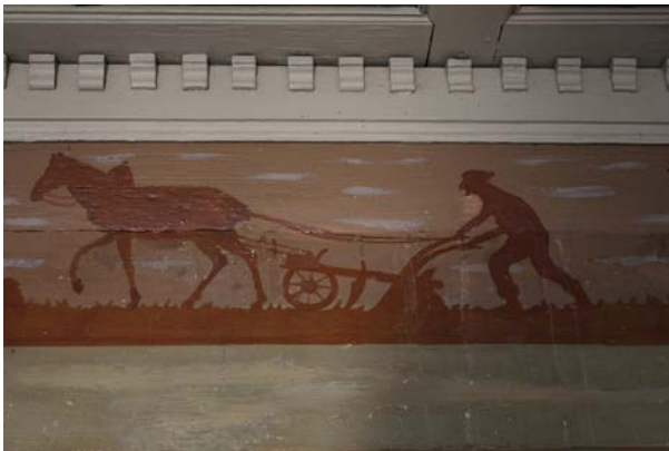
Überraschung: Erst nach der Entfernung der abgehängten Decke kam der Wandfries zum Vorschein.
